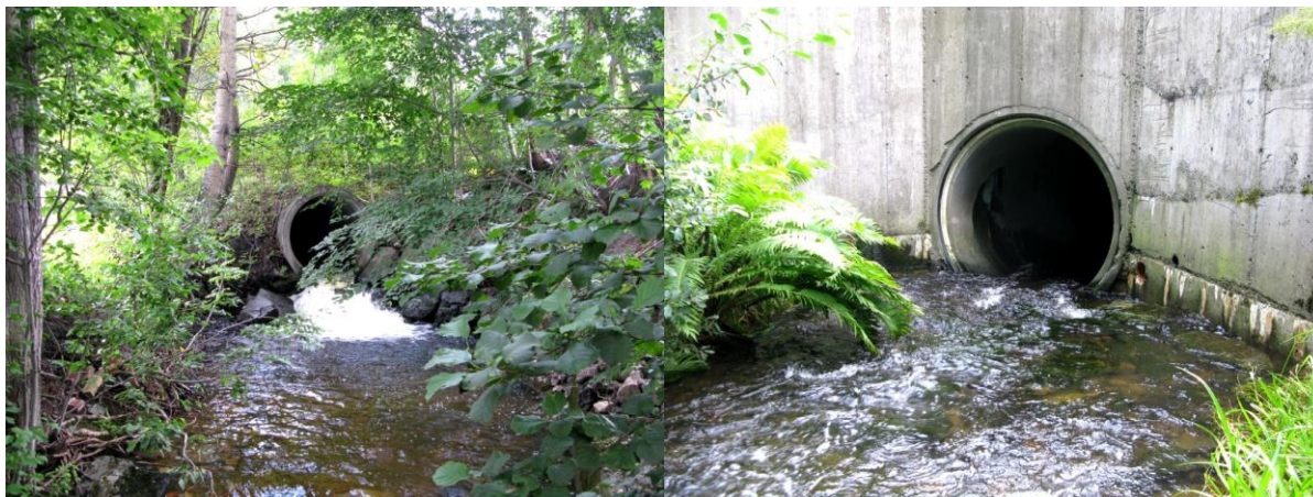
Figur 14: Bekken går i kulvert under veien nord i næringsparken. V: Nedstrøms er det nivåforskjell fra bekken og opp til røret. H: Ved innløpet oppstrøms får vannet høy fart når det går inn i røret. Fotos Ole J. Lønnve.
