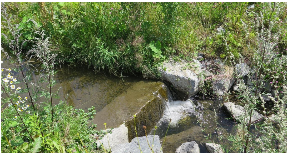
Figur 45: Store steiner plassert i den nyåpnede delen av Dælibekken langs Bærumsveien. Kan fungere som et vandringshinder for fisk. Foto: Ole J. Lønnve.
