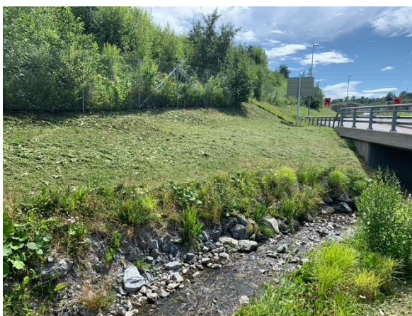
Figur 25: Nederst i strekning F er det synlig noen utfordringer med pågående erosjon. Oppkomst av vierbusker ville gi en rask stabiliserende effekt. I skråningen bak ser man oppkomst av busker og ungskog. Ideelt sett bør denne ungskogen kunne strakt seg helt ned til litoralsonen. Foto: M. Bichsel, 2022.
