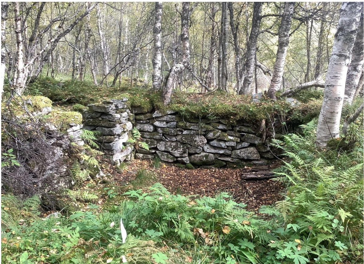
Figur 8. Grunnmuren til ett av husene som har stått her. Også oppe på muren gror det bjørk som bør fjernes om muren ikke skal ødelegges av røttene. Hogsten bør utføres med stor forsiktighet for å unngå å skade konstruksjonen. Om det er aktuelt å sette opp nye hus på Agnetligården bør en vurdere muligheten for å gjenbruke murene. Foto: Solfrid Helene Lien Langmo.
