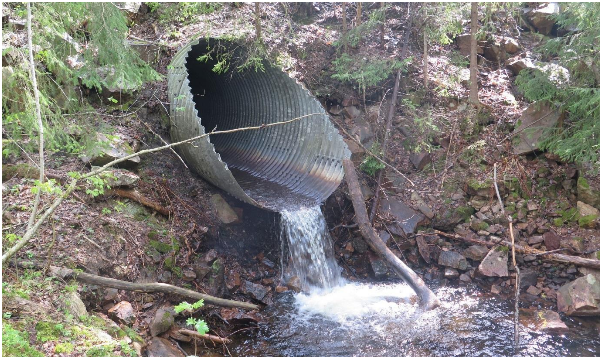
Figur 19: Kulverten under Grytnesveien er konstruert på en slik måte at den fungerer som effektivt vandringshinder for anadrom laksefisk. Laksefisk ble heller ikke observert oppstrøms Grytnesveien. Foto: Ole J. Lønnve.
