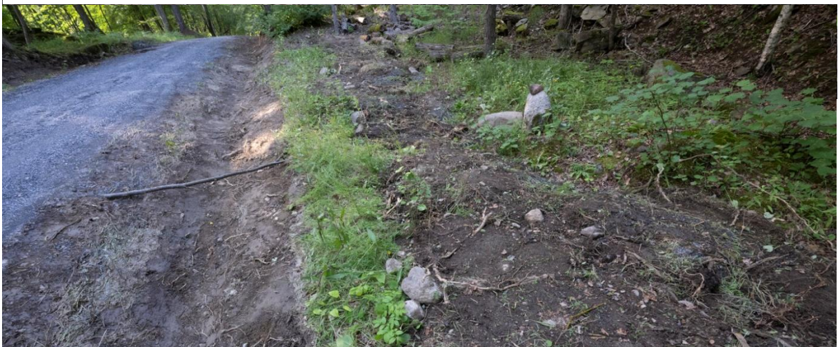
Figur 47. Flere steder var masser etter grøftegraving plassert langs veiene og dekket viktig vegetasjon. Dette har gått utover viktige karplanter som stavklokke og storvedblad, og det ble også funnet rødtuppsopp (VU) som lå nedgravd i masser langs veien.
