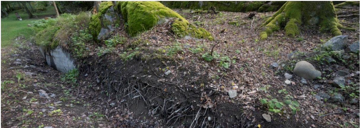
Figur 48. Grøfting tett opptil store gamle trær er svært uheldig.
