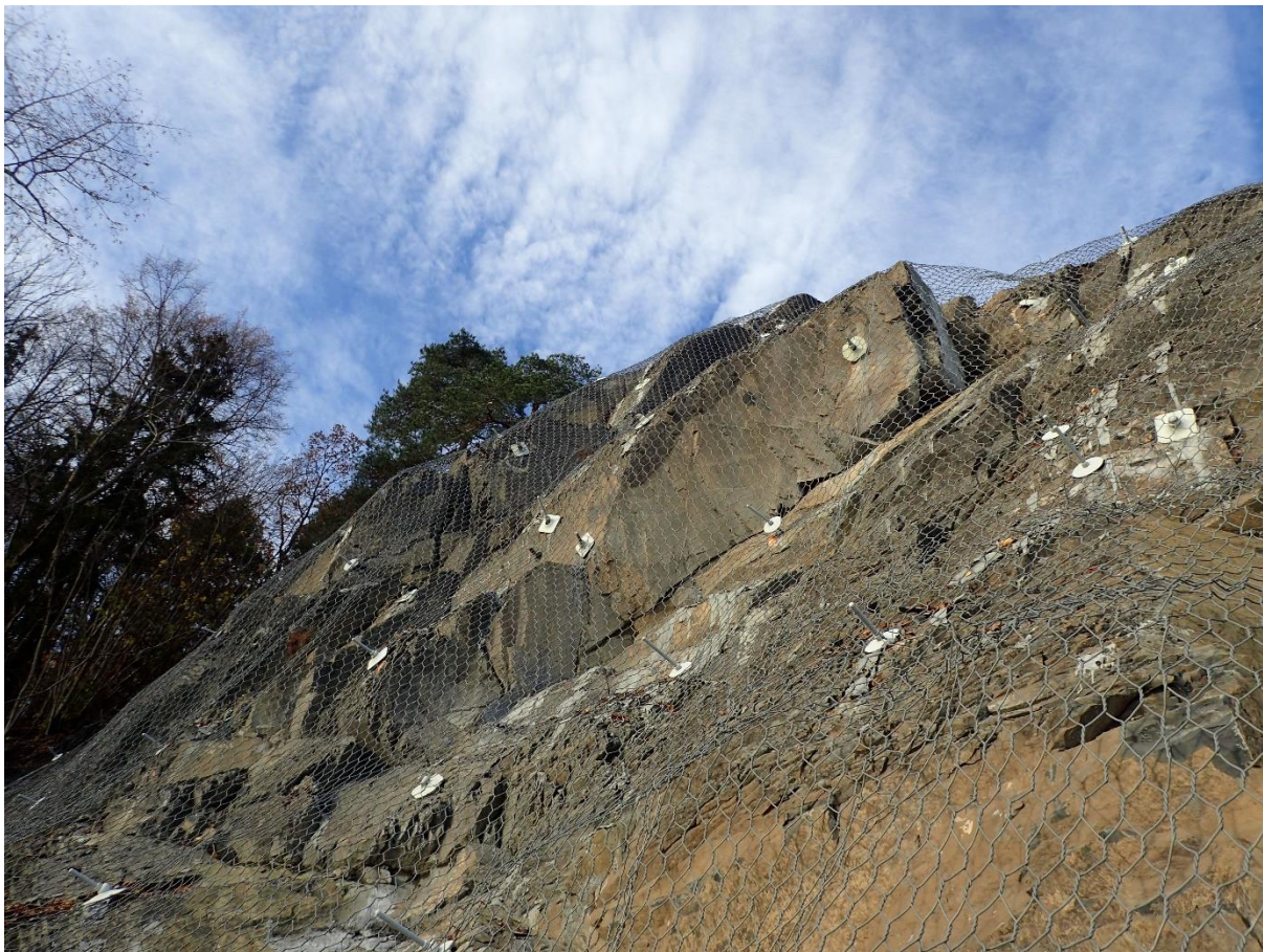
Figur 5: Rassikring på Ormodden i Asker kommune.
